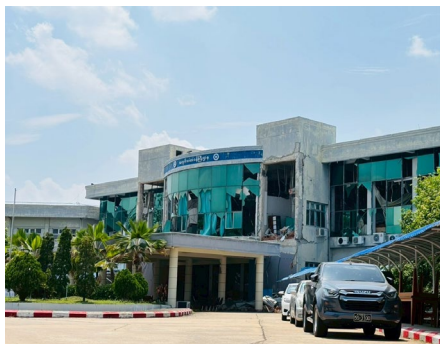
ネピドー被災状況
